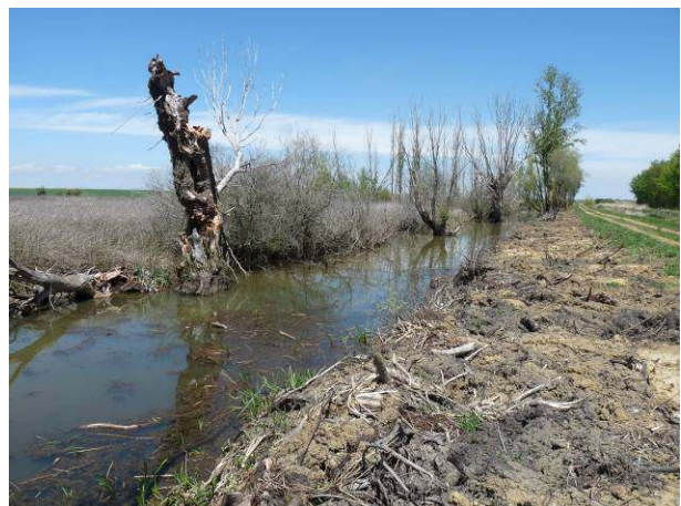
Los trabajos de limpieza y acondicionamiento de cauces han producido severos daños en algunos de estos humedales, como el sufrido recientemente en la Laguna de Valdemorco 1 .
