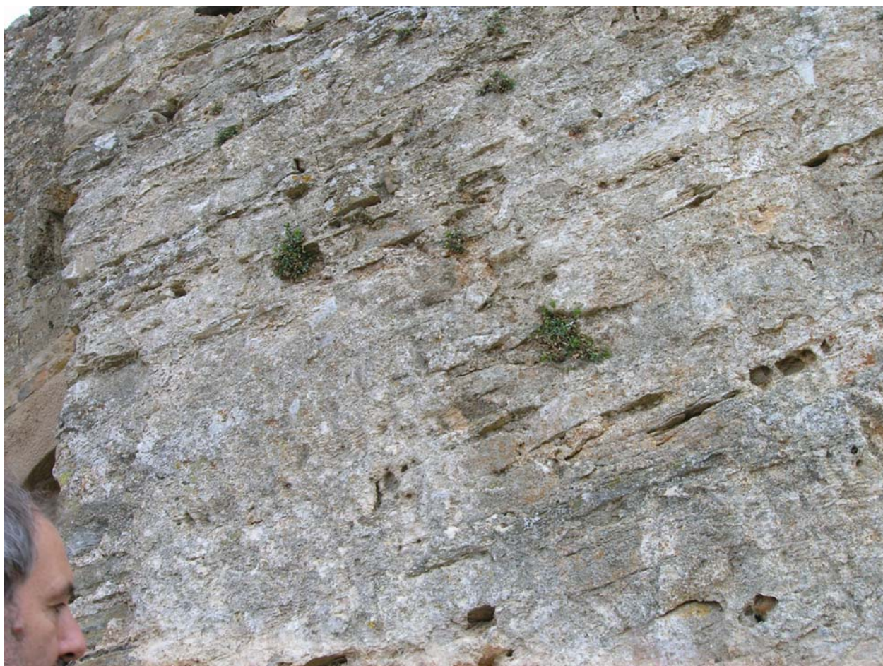
Fotografía 9. Aspecto del muro norte de la entrada a la fortaleza casi completamente “limpia” de plantas tras la restauración
